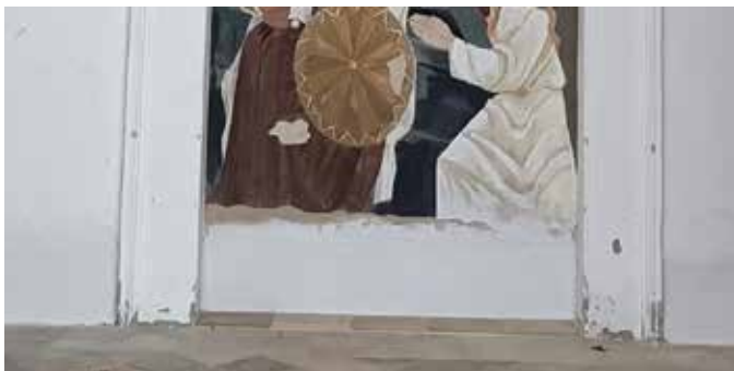
Die umfangreichen Schäden im Sockelbereich
